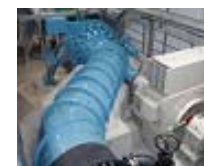
水力発電設備
