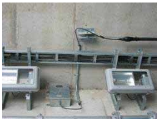
配線用ラック
