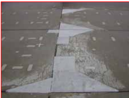
PPC版劣化状況
