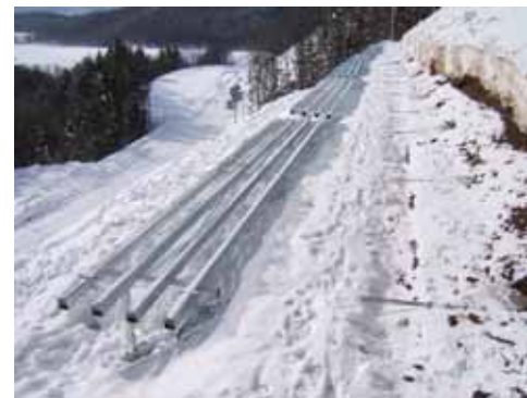
スノテップ(小段付法面雪崩防止工)
