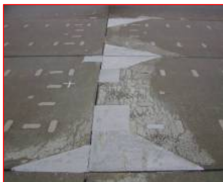
PPC版劣化状況
