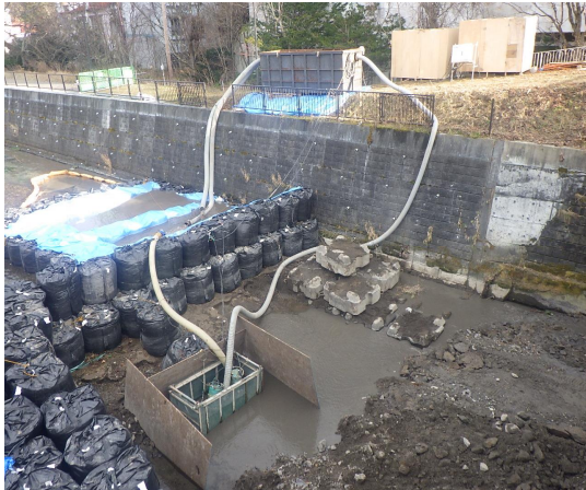
ポンプ運転状況
