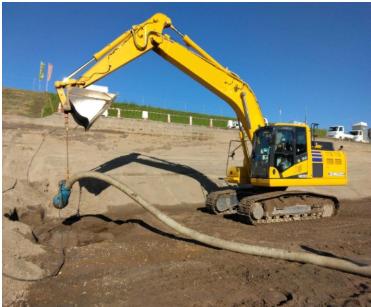
ポンプ設置状況
