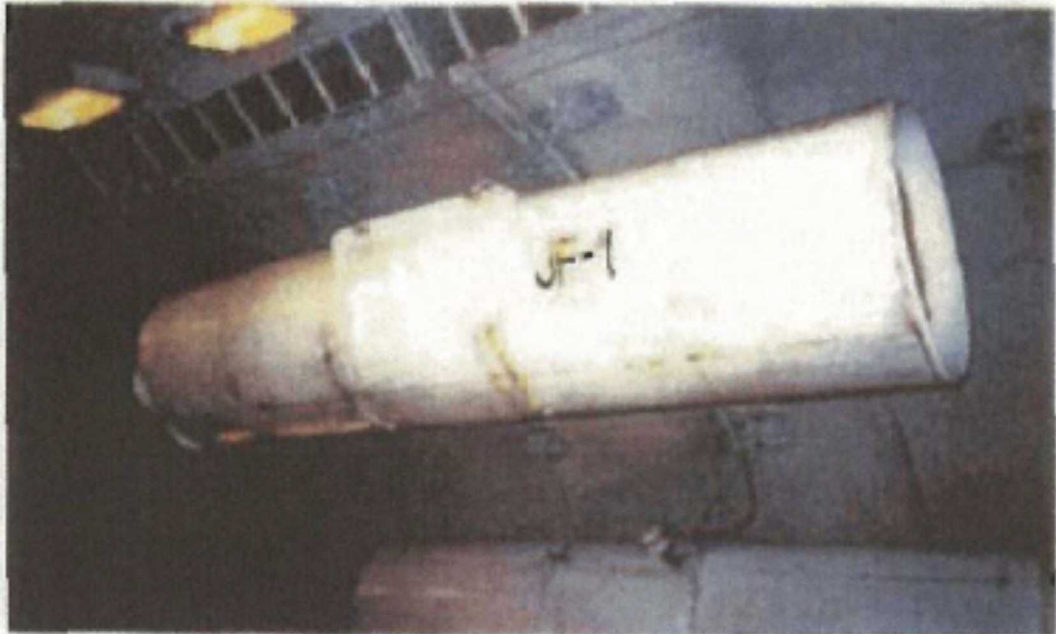
写真－１ 発錆、腐食状態のランク [B]
