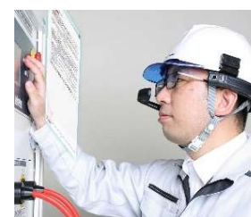
プラント制御盤
