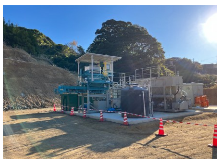
濁水処理設備外観
