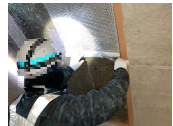
トンネル補修工 剥落防止対策工 (可視繊維シート接着工法)
