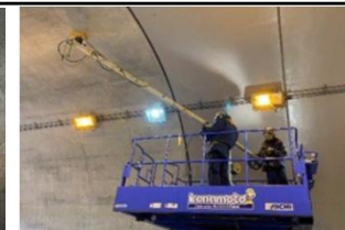
レーダーを利用した トンネル覆工の変状把握
