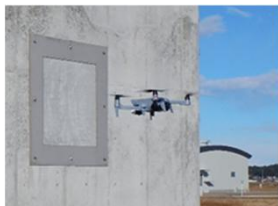
ドローンによる損傷把握
