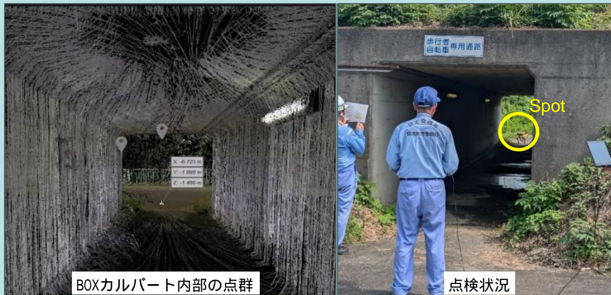
BOXカルバート内の点検状況（令和6年8月 佐野市との合同防災訓練）
