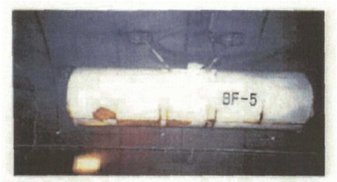
写真－３ 発錆、腐食状態のランク [D]
