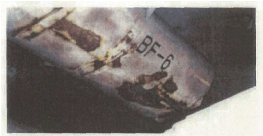
写真－４ 発錆、腐食状態のランク [E]
