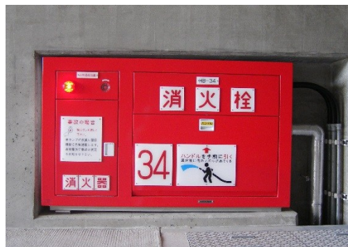
トンネル非常用施設の事例
