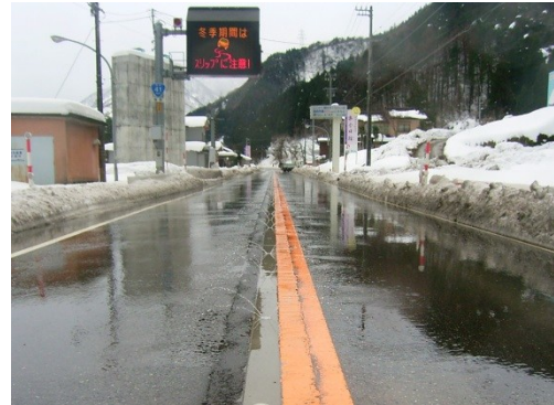
消融雪設備の事例
