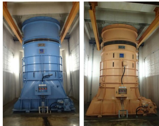
送・排風機設備の事例
