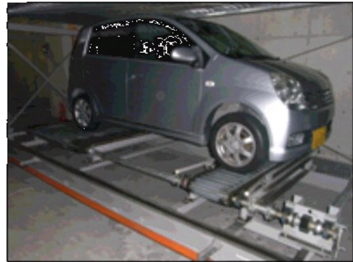
機械式駐車場設備の事例
