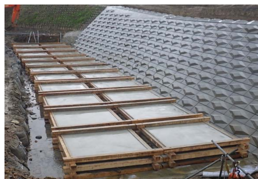
遠賀川水系犬鳴川（福岡県宮若市） 『根固め工』
