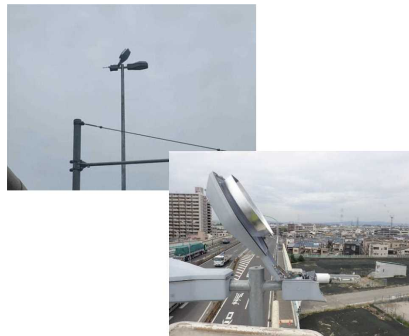
図 国道25号における照明灯具破損・落下事故 (左:発見時の状況、右:破損状況)
