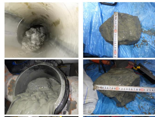
■1598リング掘進時の配管閉塞
