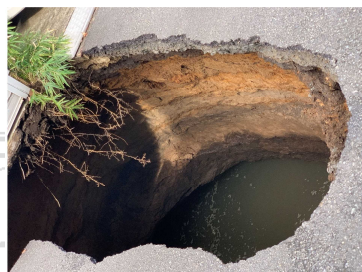
陥没箇所状況写真
