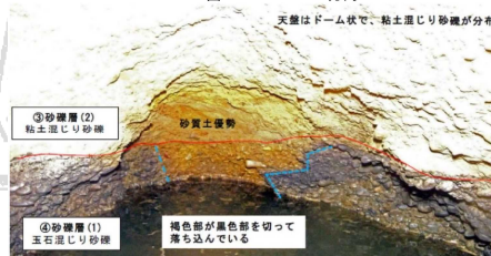
空洞①状況写真
