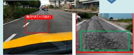
舗装の損傷状況を自動検知
