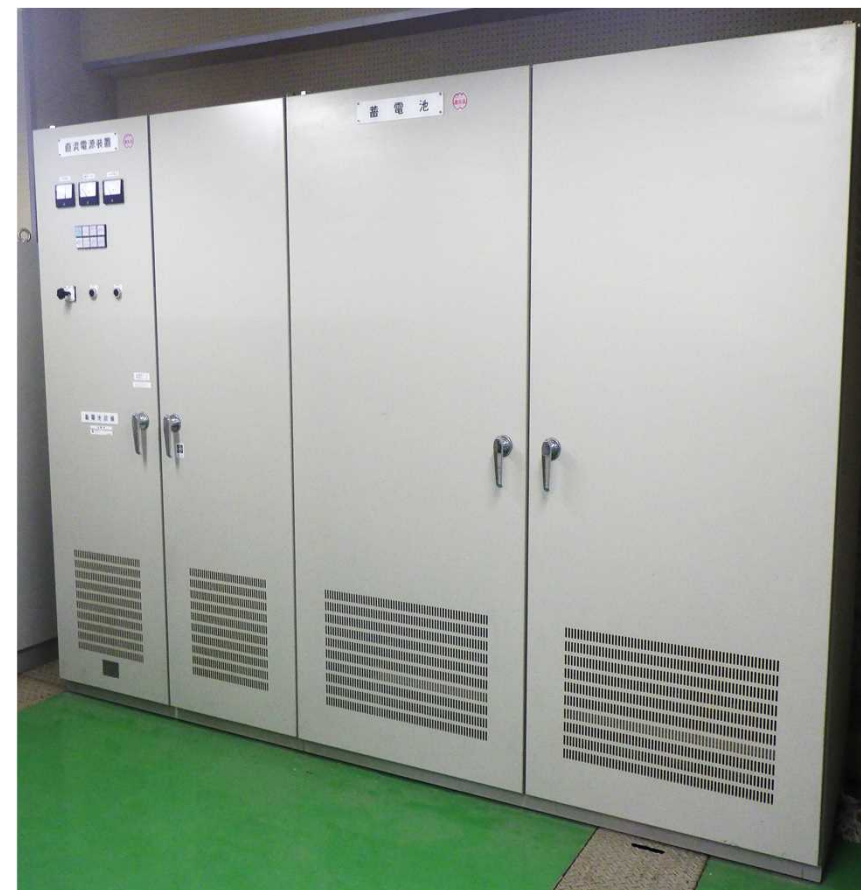
直流電源設備の例
