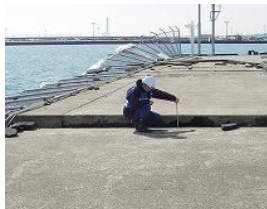
津波警報解除後の 現地調査(陸上)
