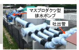
マスプロダクツ型排水ポンプ設置例 (福岡県福智町)
