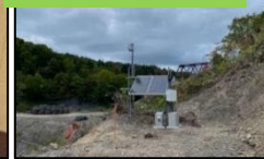
現場カメラによる遠隔監視
