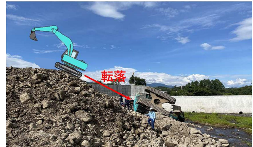
図 事故状況写真
