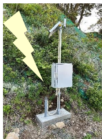
地下水位自動計測
