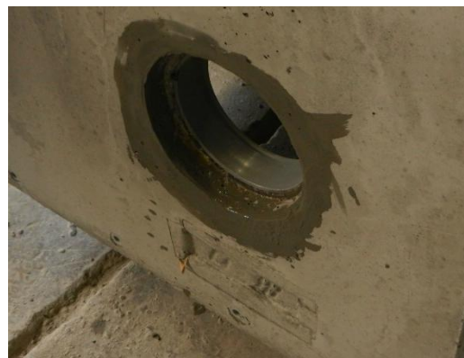
写真 8-2 補修箇所(角欠け)
