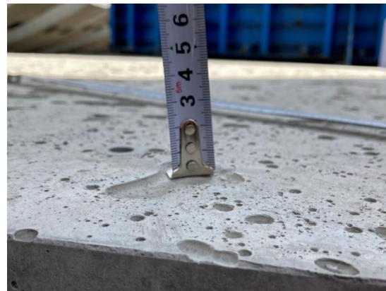
写真 5-4-7 表面気泡(水平(斜め))の事例
