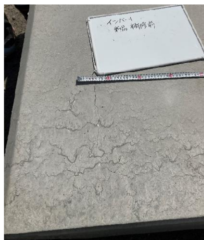
写真 5-3-2 ペースト漏れ
