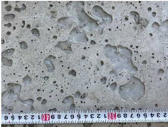
写真 5-4-6 表面気泡(水平(斜め))の事例
