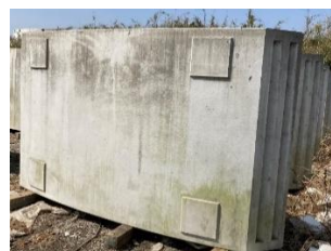
写真 5-5-2 長期保管による汚れ
