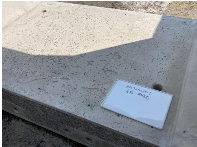
写真 5-4-5 表面気泡(水平(斜め))の事例
