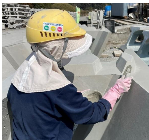
写真 8-3 補修状況(角欠け)
