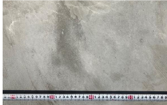
写真 5-3-6 補修後(ペースト漏れ)
