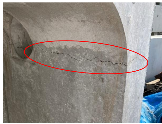
写真 7-3 不合格事例(ひび割れ)
