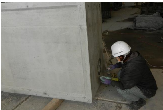
写真 8-1 補修状況(角欠け)
