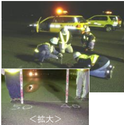
<拡大> <くわだち掘れ計測>
