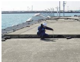
津波警報解除後の 現地調査(陸上)
