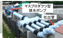
マスプロダクツ型排水ポンプ設置例(福岡県福智町)
