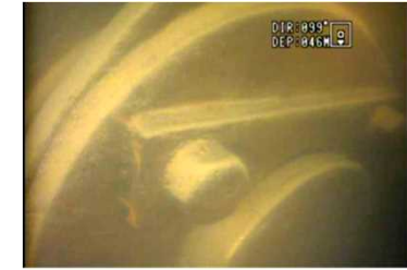
取水ゲート設備
