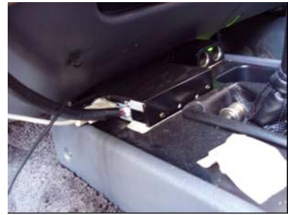
図 2-11 GPS 本体設置状況
