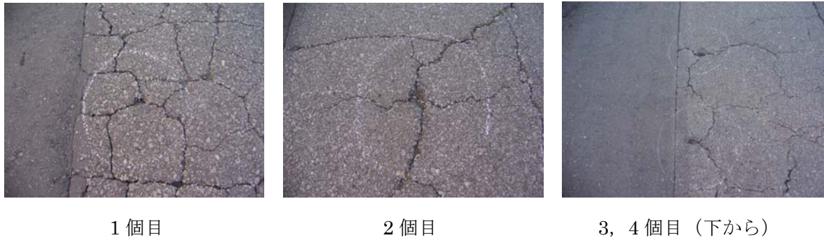
図 4-63 ポットホール
