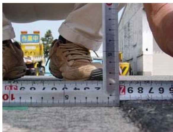
図 4-36 段差量計測状況
