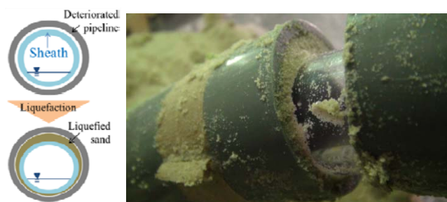
図 3－5 8 シース管を有する場合の管継手の破損
