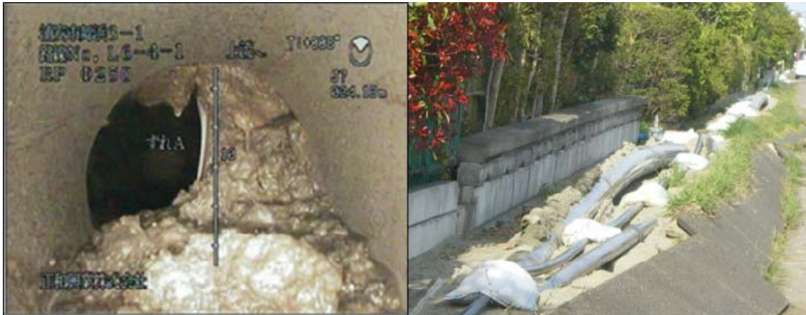
図 1－1 下水管路の閉塞と浮き上がり被害例（左：浦安市 右：潮来市）
