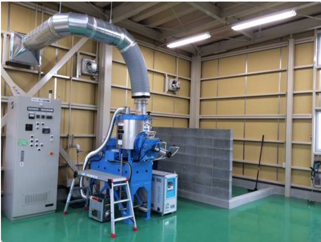
(実験棟内ミキサー)
