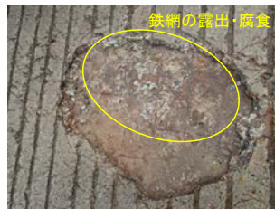
(b) 表面コンクリートの剥離事例
