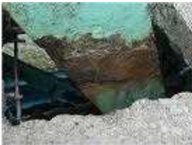
鋼トラス部材の埋め込み部の破断
