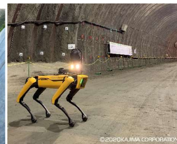
4足歩行ロボット現場巡回 (鹿島建設HPより*)
