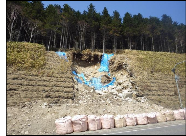
オーバーハング状の被災箇所
