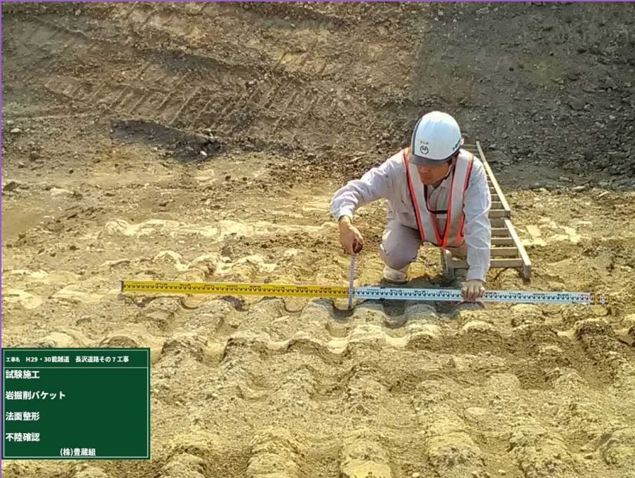
従来施工の不陸状況(平均40mm)
