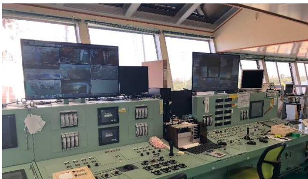
WEBカメラによる設備監視画面モニター
