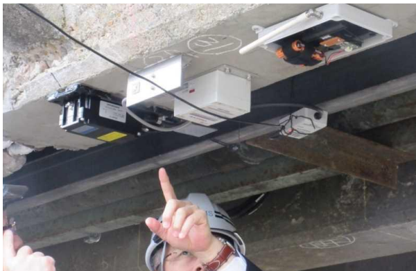
センサー設置状況
