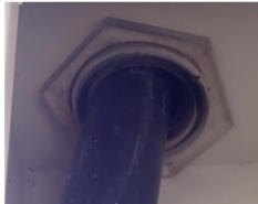
引込開閉器盤内部より撮影
