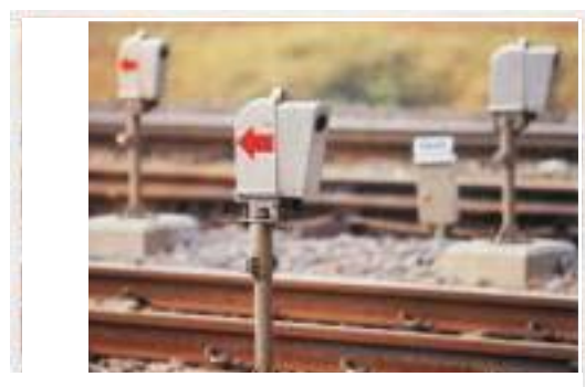
踏切障害物検知装置
