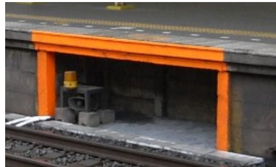
ホーム下の待避スペース
