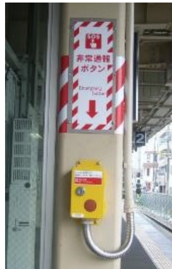
非常停止押しボタン
