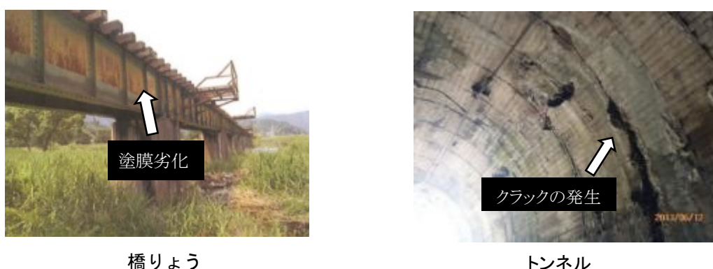
図4：老朽化が進んでいる施設の例
