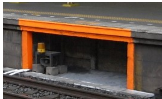
ホーム下の待避スペース
