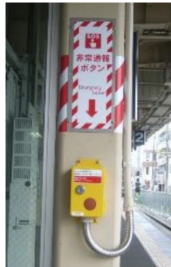
非常停止押しボタン
