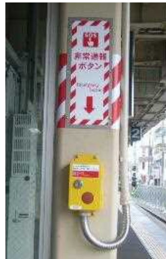
非常停止押しボタン
