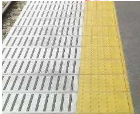
内方線付き点状ブロック
