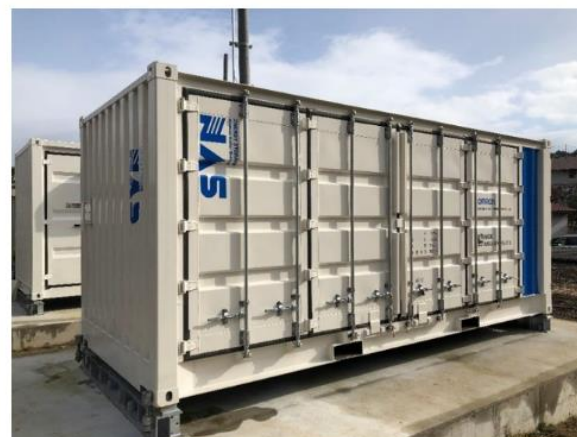
オムロン宮津太陽光発電所に設置した大容量蓄電池NAS®電池（日本カイン株式会社製）
