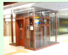
エレベーター
