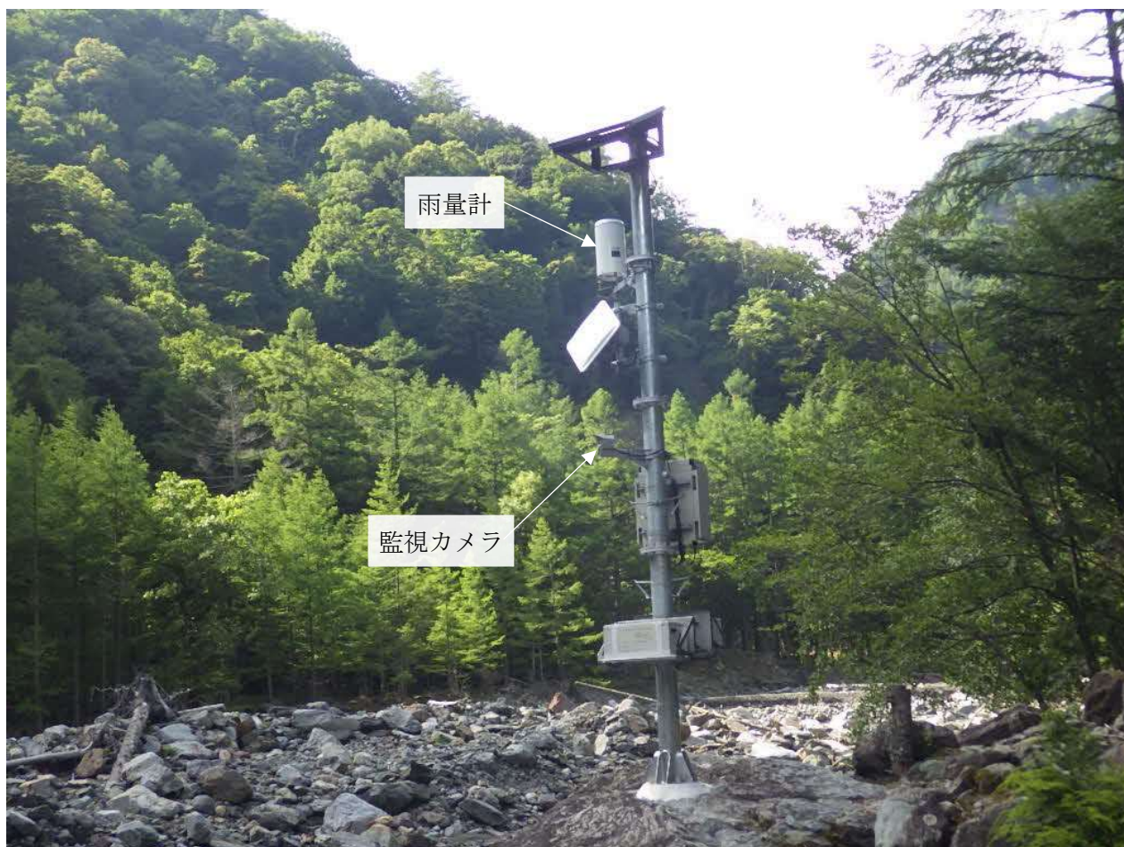
図 7 常時監視カメラ、雨量計の設置状況（蛇抜沢）
