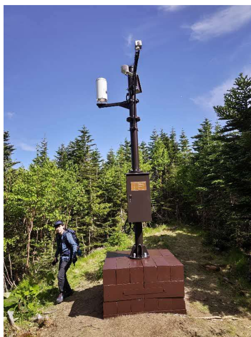
図 21 雨量計・積雪深計等の設置状況（千枚小屋付近）
