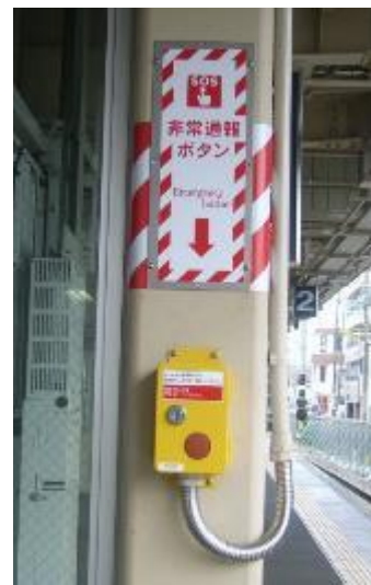
非常停止押しボタン
