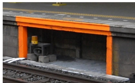
ホーム下の待避スペース
