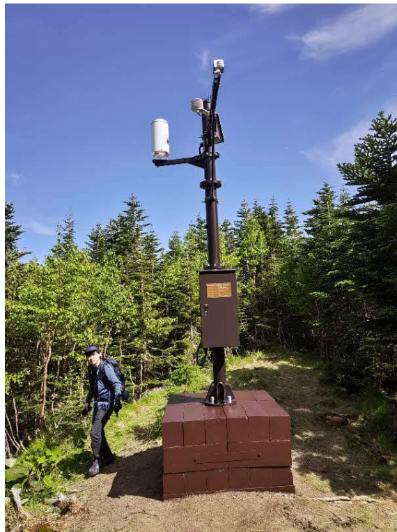
図 4.15 雨量計・積雪深計等の設置状況（千枚小屋付近）
