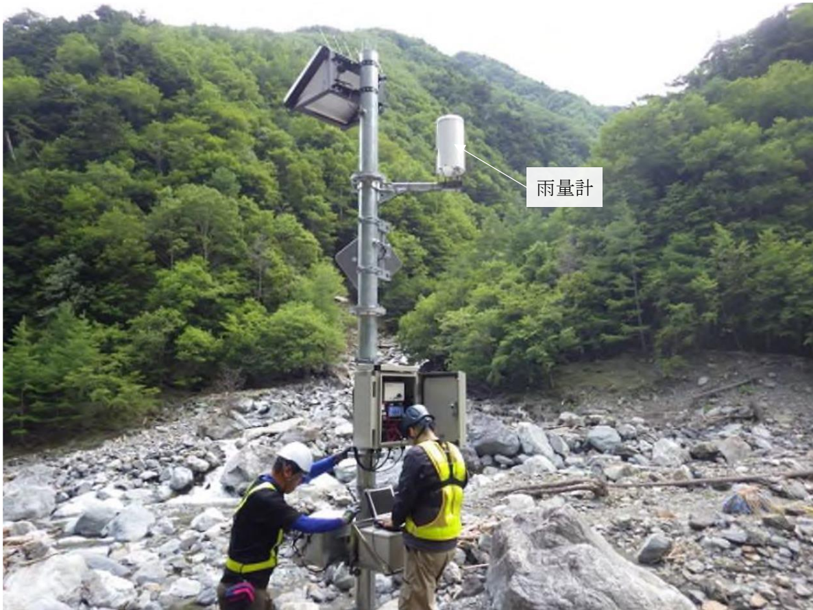
図 3.90 常時監視カメラ、雨量計の設置状況（蛇抜沢）
