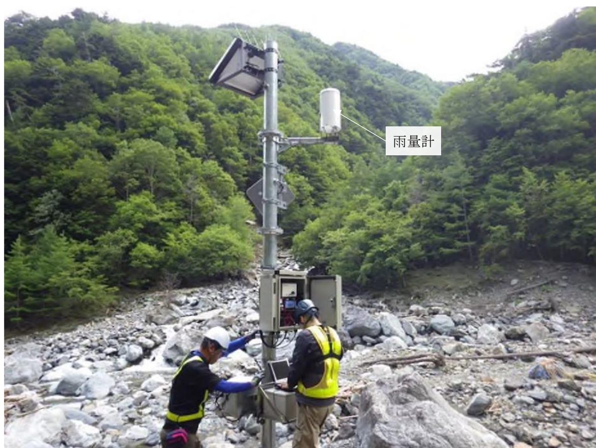
図 3.90 常時監視カメラ、雨量計の設置状況（蛇拔沢）
